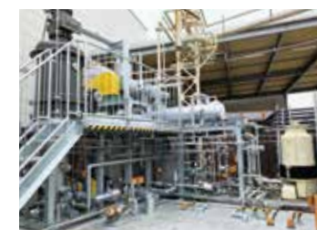
排水処理工程の 電気式ヒートポンプ化
