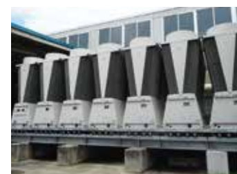
空調機用の電気式チラー
